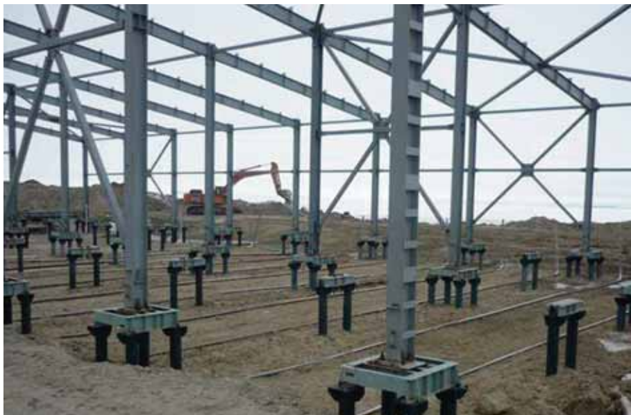
Рис. 7. Устройство горизонтальных термостабилизаторов типа ДОУ-1 при строительстве здания с полами по грунту на Бованенковском НГКМ
