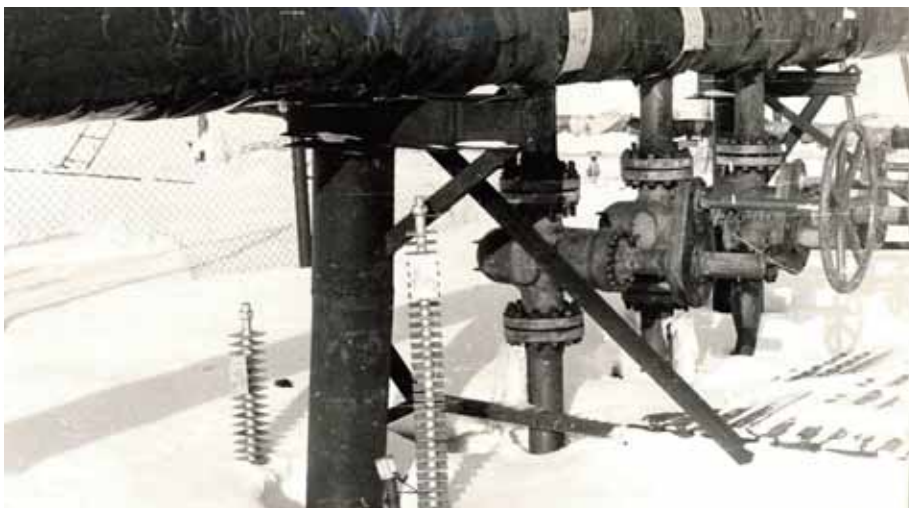
Рис. 6. Термостабилизаторы типа ТМД-4 на опорах надземного газопровода
