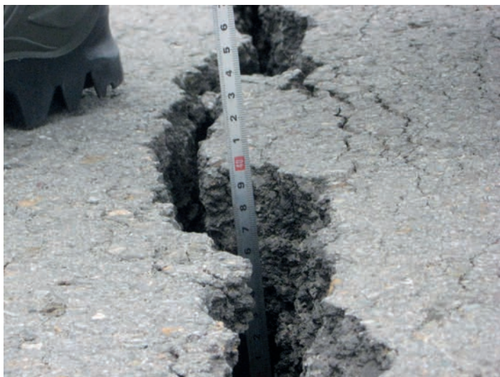
Деформационные трещины асфальтобетонного покрытия на участке деградации многолетнемёрзлых грунтов основания земляного полотна. Федеральная автодорога «Амур». Фото Дмитрия Шестернёва, заведующего лабораторией инженерной геокриологии ИМЗ СО РАН
